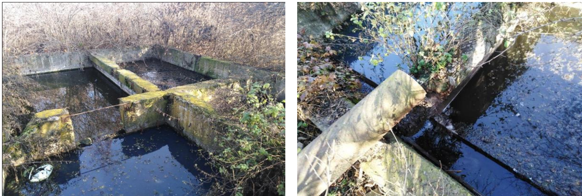
Рис. 2. Недіючі очисні споруди комунальної лікарні м. Копичинці (30 м до р. Нічлавка)
